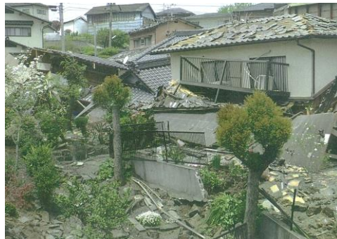
軟弱地盤による住宅被害
